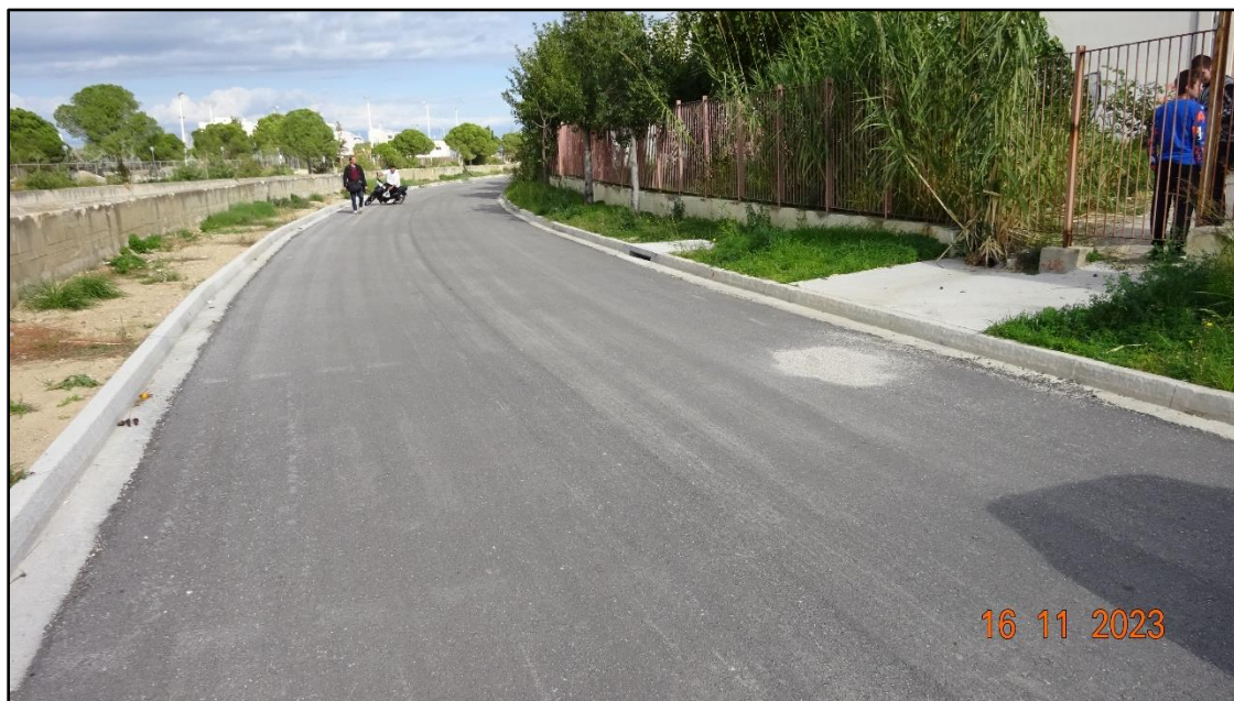
Εικόνα 14 (Ξυλόκαστρο) : Η οδός Ν.Λάσκου στο ύψος του ΤΕΛ με αδιαμόρφωτα πεζοδρόμια.
